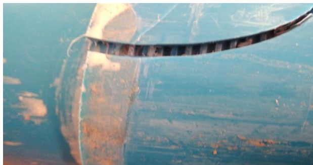
Рисунок 2. Разрушение резьбового соединения труб НПВХ на глубине 60 м.
